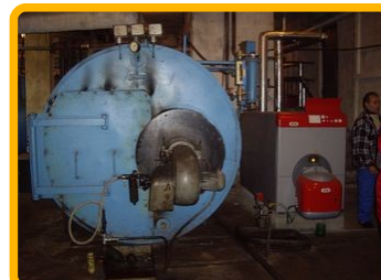
Ancienne et nouvelle chaudières
