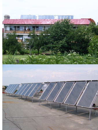
Les panneaux solaires
